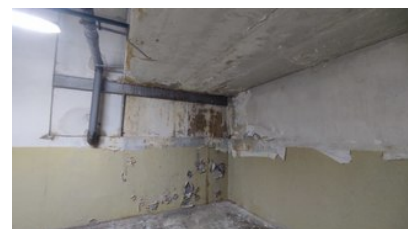
10 detail zatékání do konstrukce
