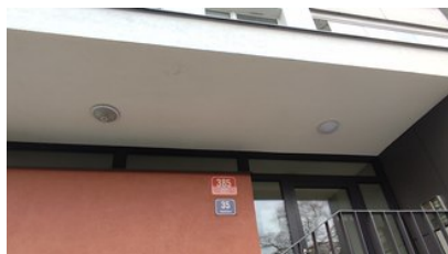
3 markýza Ondříčkova 35 -zatékání do osvětlení
