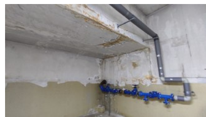
14 detail zatékání do konstrukce
