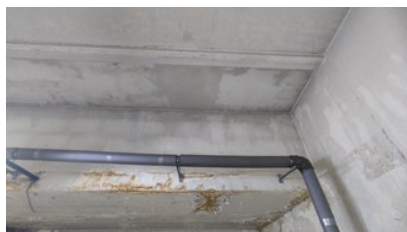
19 detail zatékání do konstrukce
