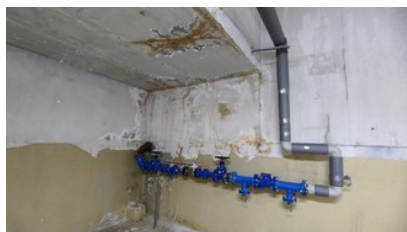
15 detail zatékání do konstrukce
