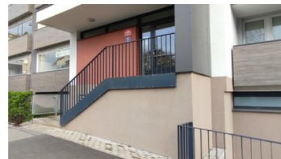
2 markýza Ondříčkova 35 -zatékání do osvětlení
