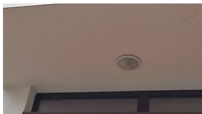
5 markýza Ondříčkova 35 -zatékání do osvětlení
