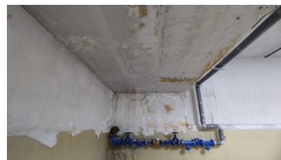
16 detail zatékání do konstrukce
