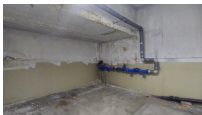
13 detail zatékání do konstrukce
