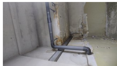
20 detail zatékání do konstrukce
