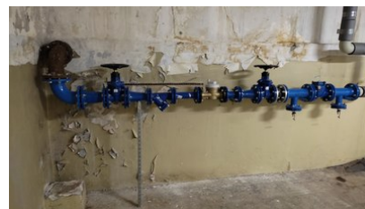
18 detail zatékání do konstrukce
