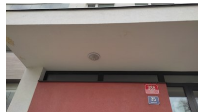
4 markýza Ondříčkova 35 -zatékání do osvětlení
