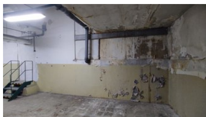
11 detail zatékání do konstrukce
