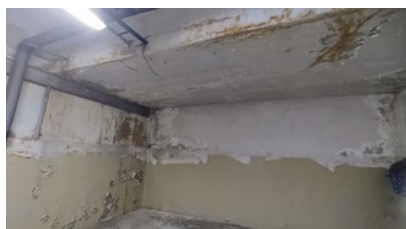
9 detail zatékání do konstrukce
