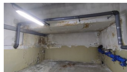
8 detail zatékání do konstrukce
